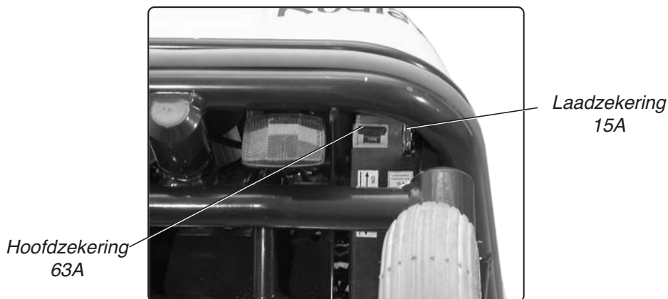
Afb. 37. Hoofdzekering en laadzekering
